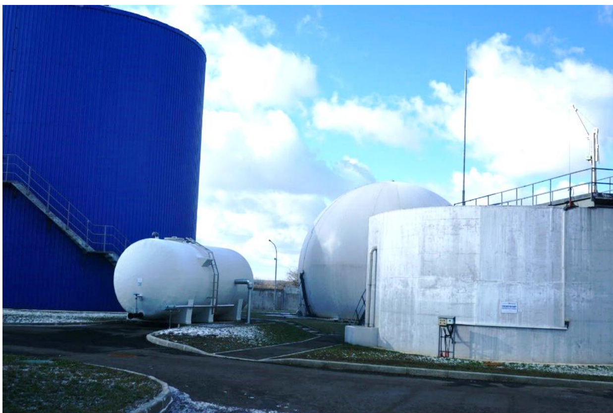
FIGURA 19 - INSTALAȚIE DE PRODUCȚIE BIOGAZ
