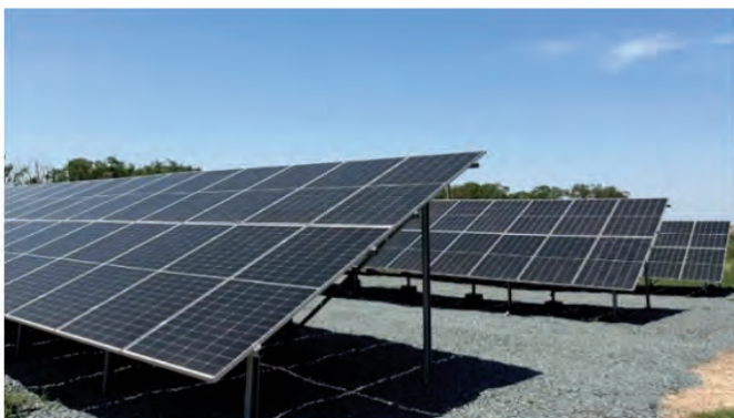
CEF Stația Tatlageac / Tatlageac PV Power Plant
