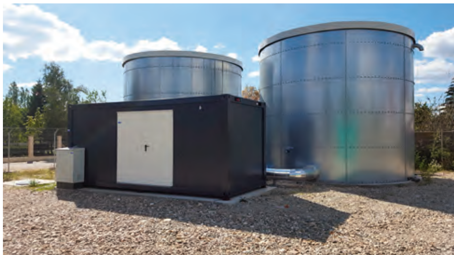
Fig. 2. Gospodărie apă Bradu / Bradu water utility
