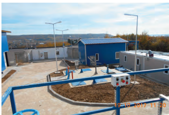
Fig. 4. Gospodărie apă Topoloveni / Topoloveni water utility
