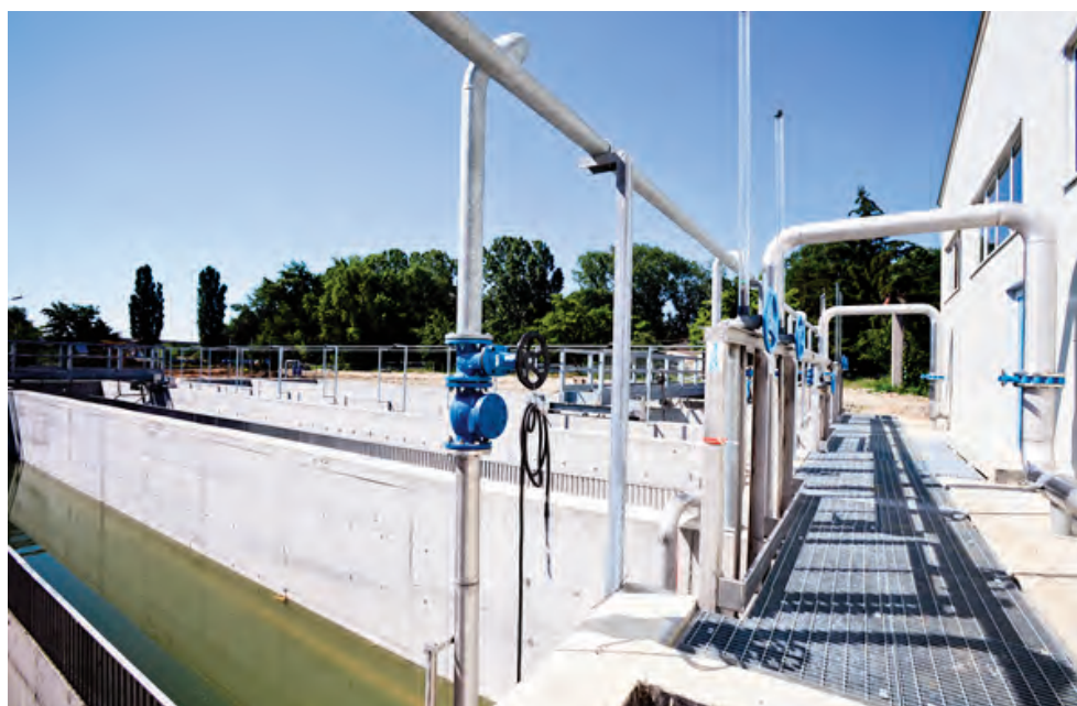
Fig. 5. Stația de Epurare Pitești / Pitesti Wastewater Treatment Plant
