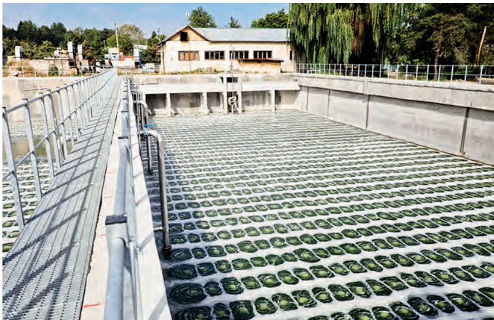
Fig. 6. Stație de Epurare Ape Uzate Pitești - Bazinul de aerare nr. 2 / Pitesti Wastewater Treatment Plant - Aeration basin no. 2
