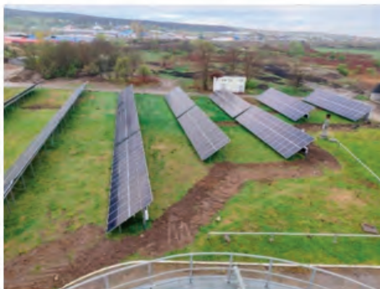
Fig. 13. Panouri fotovoltaice Stația de Epurare Zalău / Photovoltaic panels Zalau Wastewater Treatment Plant
