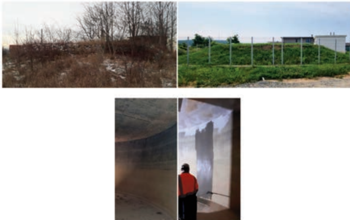
Figura 8., 9. Relevu fotografic (înainte / după) lucrările de reabilitare (exterior + interior) - rezervor subteran 500 m 3 Vișan / Figure 8., 9. Photographic survey (before / after) rehabilitation works (exterior + interior) - Visan 500 m 3 underground water tank
