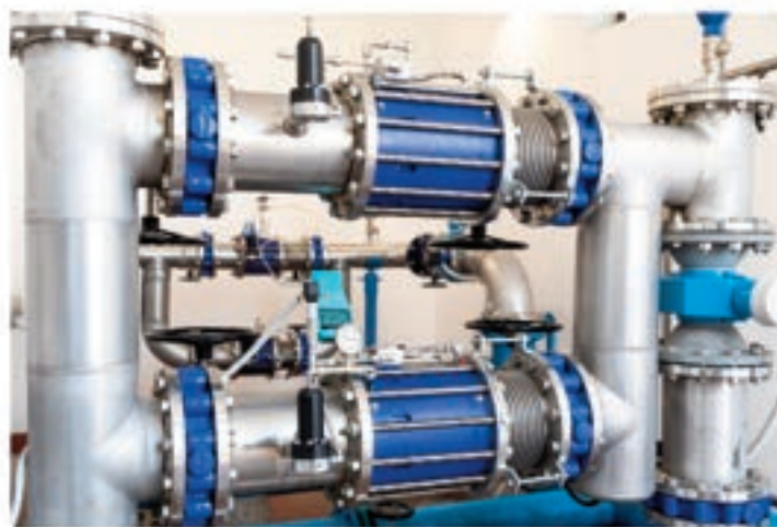
Fig.: Supapa de control al presiunii ar putea fi instalată direct în sistemul de alimentare cu apă al IRETI/ Fig.: The pressure control valve could be installed directly in IRETI's water supply system.
